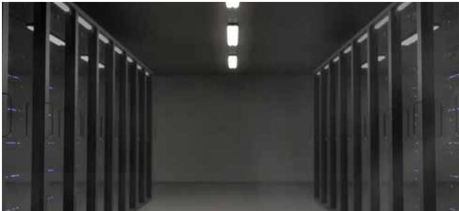
RYSUNEK 14. Przykładowa serwerownia
